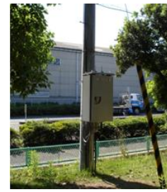
図 4 水質自動監視装置
