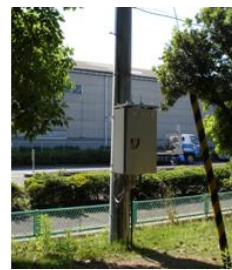
図4 水質自動監視装置
