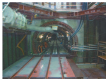
【中部バイパス第2幹線工事(1工区)】平成23年6月末 完成予定 玉藻町～福岡町の約1,300m 仕上がり内径 2m60cm
