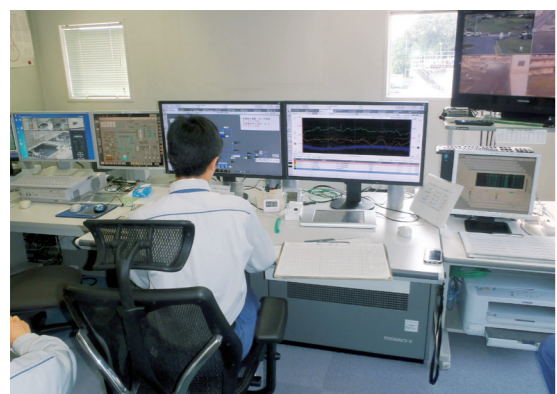
▲更新後の中央監視制御システムPC
