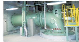
▲増設した雨水ポンプ(口径1,500mm)
