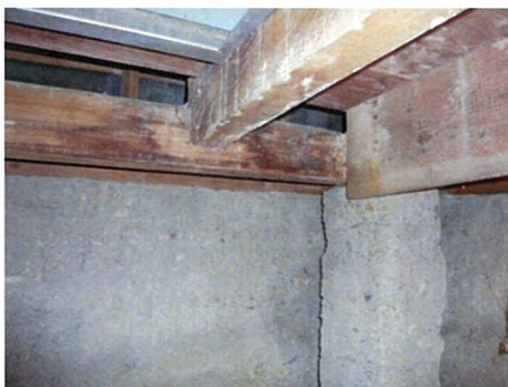
写真 3-1)-19 資料室2（増築部） 以前白蟻防除工事を実施した土台
