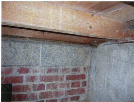
写真 3-1)-15 資料室1 煉瓦基礎と土台の取り合い部
