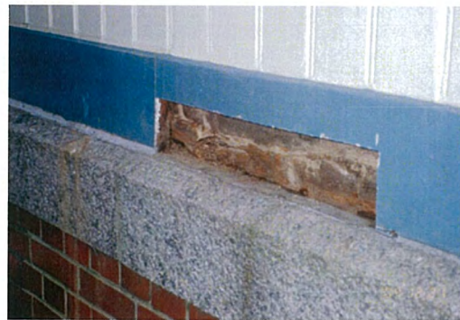
PR館 土台 イエシロアリ被害
