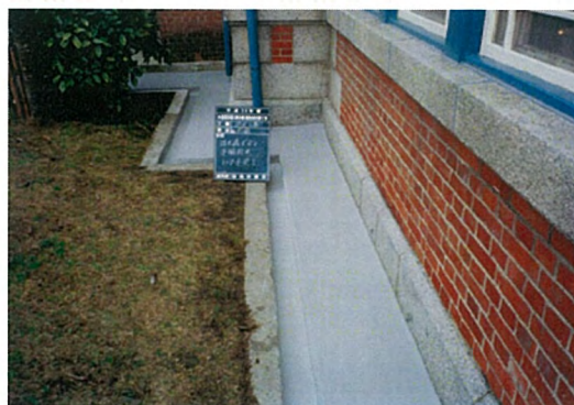
歴史館 犬走り・排水溝 塗膜防水
