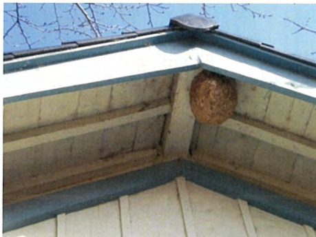
写真 3-1)-5 倉庫上部の蜂の巣
