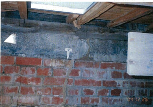
PR館 床下 蟻道
