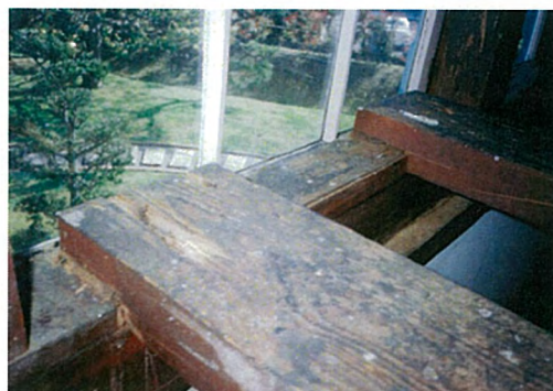
歴史館北側 梁2本 イエシロアリ被害 (取替済)
