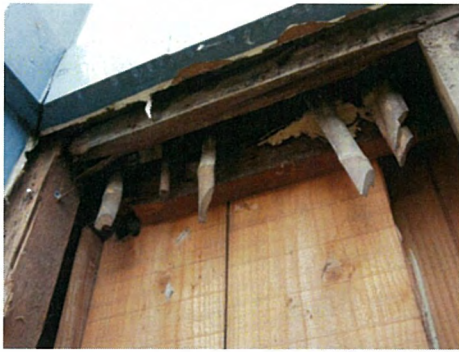
写真 3-1)-30 ②小舞及び土壁状況
