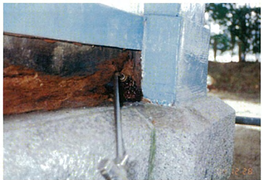
PR館 土台イエシロアリ被害 （油剤処理済）
