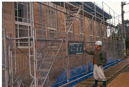
PR館 剥離・ケレン状況
