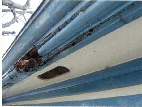
写真 3-1)-3 軒樋下部の木部腐朽状況
