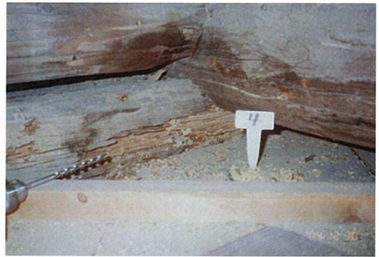
PR館 天井内 イエシロアリ営巣部
