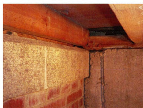
写真 3-1)-20 資料室2（増築部） 腐朽した土台
