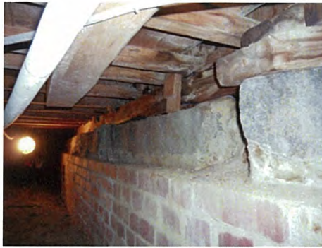
写真 3-1)-21 資料室 3 以前白蟻防除工事を実施した土台
