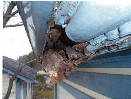
写真 3-1)-4 木部腐朽状況と内部に生息している蜂
