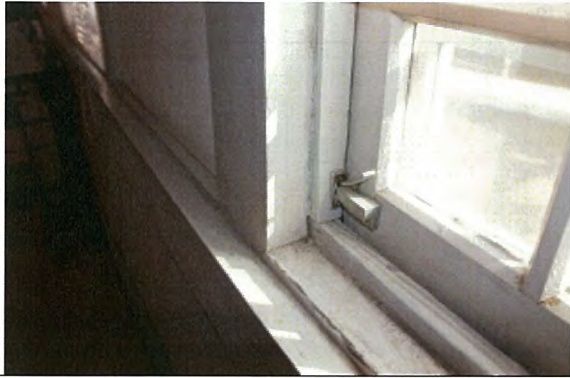
木部の塗膜の剥落
