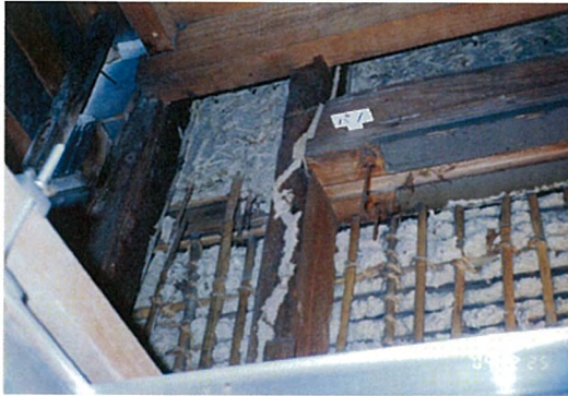
PR館 資料室2 天井内 柱にイエシロアリの蟻道
