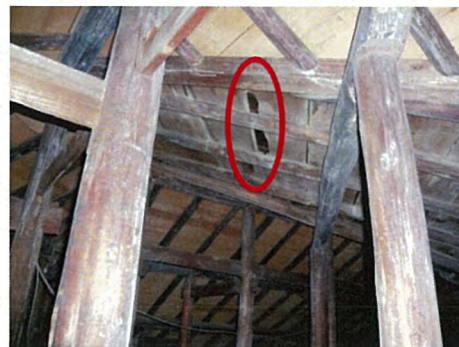
写真 3-1)-7 野地板の欠損部
