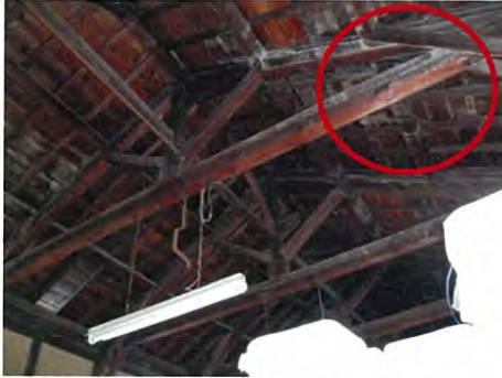
写真 3-1)-14 野地板の漏水痕
