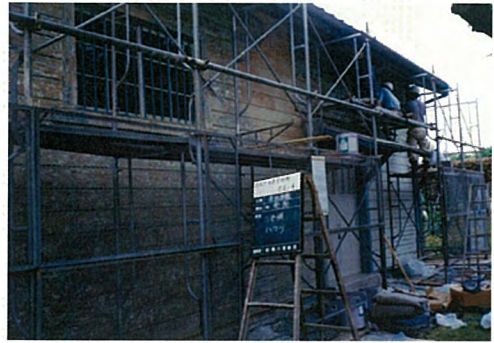
倉庫 剥離状況
