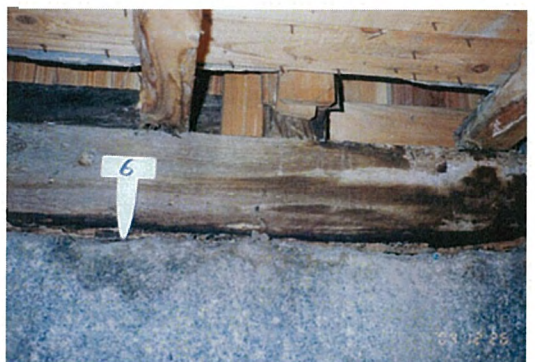
PR館 土台 下端 イエシロアリに食害
